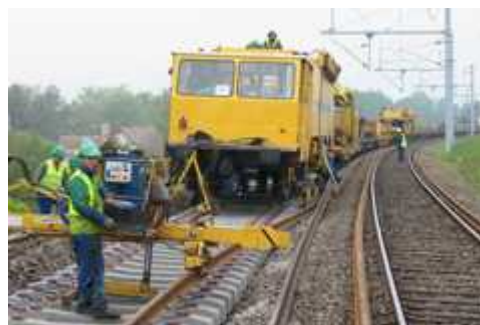
Longs Rails soudés sur traverses béton
