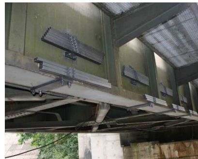
absorbeur sur platelage
